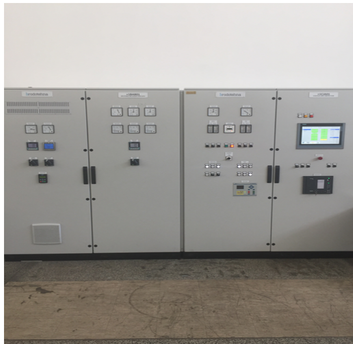
Slika 3.3: Razvodni i upravljački ormar hidroelektrane.
