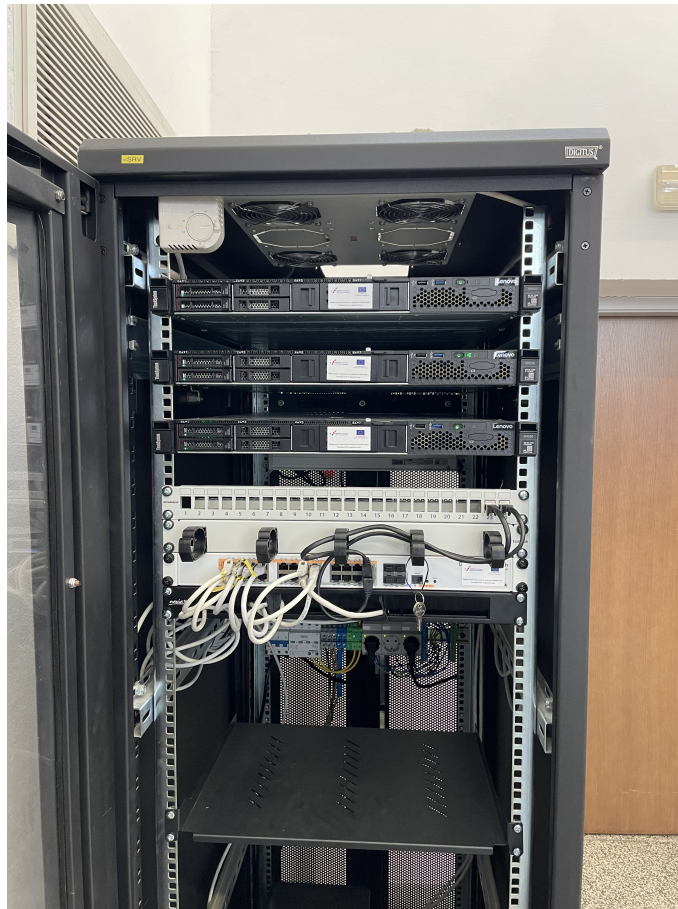
Slika 3.2: SGLab - ormar sa serverima.
