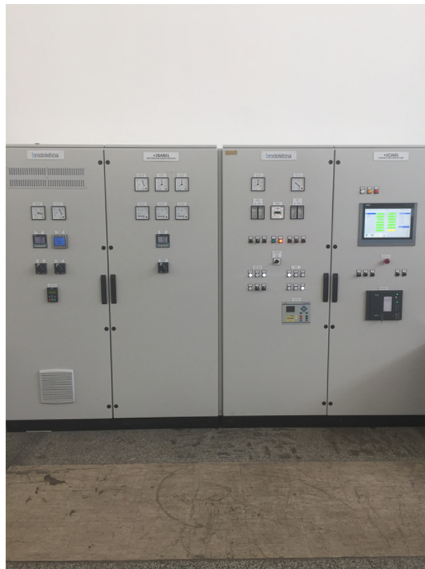
Slika 3.7: SGLab - ormar razvoda i upravljački ormar hidroelektrane.
