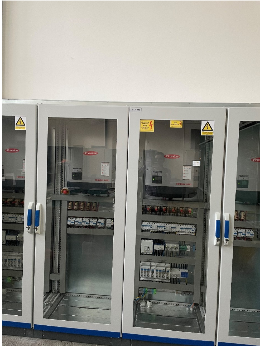
Slika 3.9: SGLab - ormar s FRONIUS inverterima fotonaponske elektrane.
