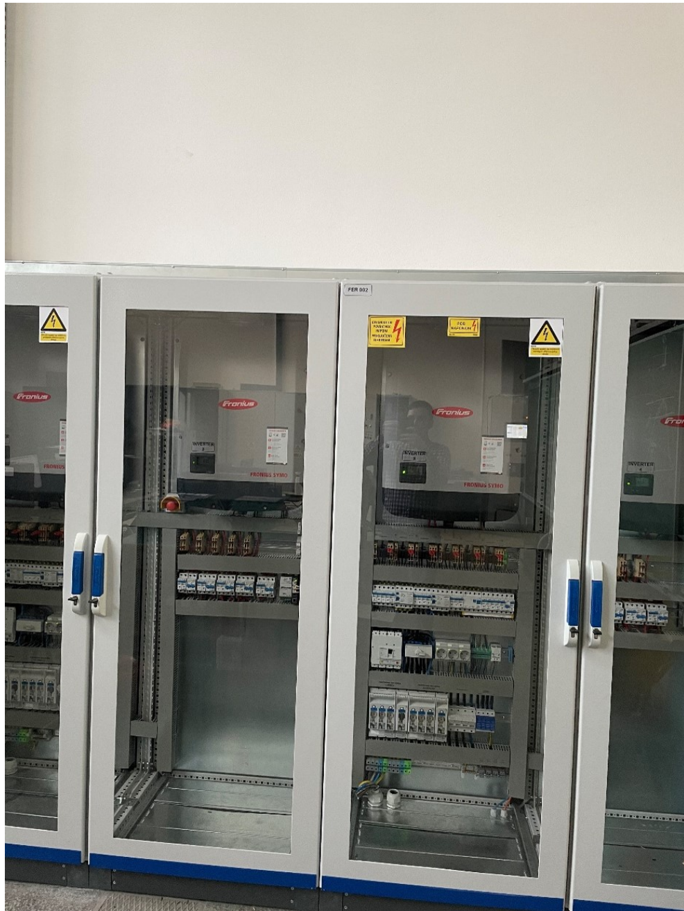
Slika 2.9: SGLab - ormar s FRONIUS inverterima fotonaponske elektrane.
