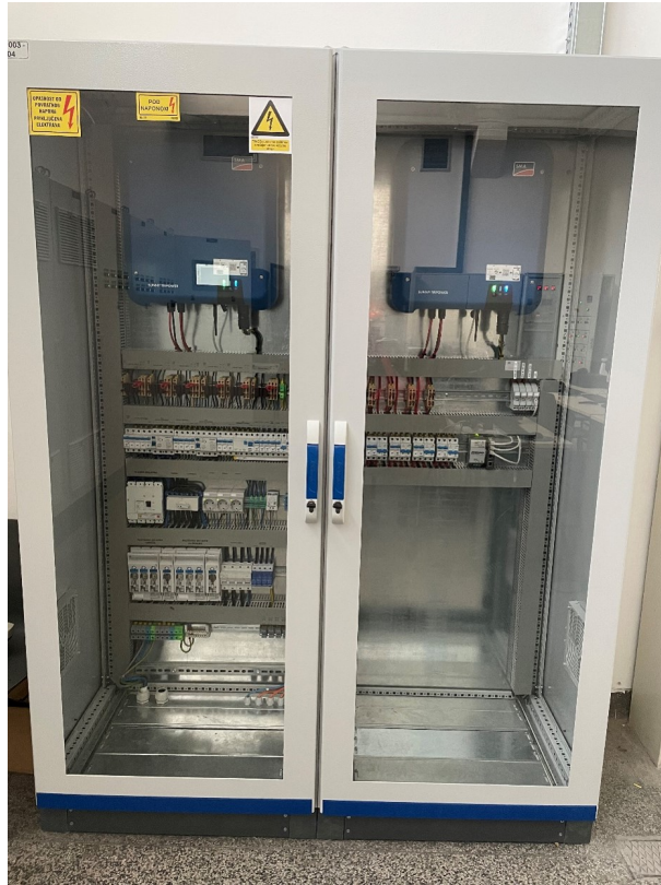
Slika 2.8: SGLab - ormar sa SMA inverterima fotonaponske elektrane.
