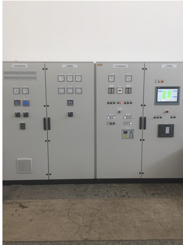
Slika 2.7: SGLab - ormar razvoda i upravljački ormar hidroelektrane.
