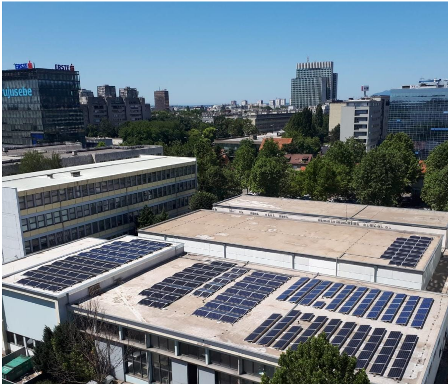
Slika 2.10: SGLab - fotonaponski paneli na krovu laboratorija.
